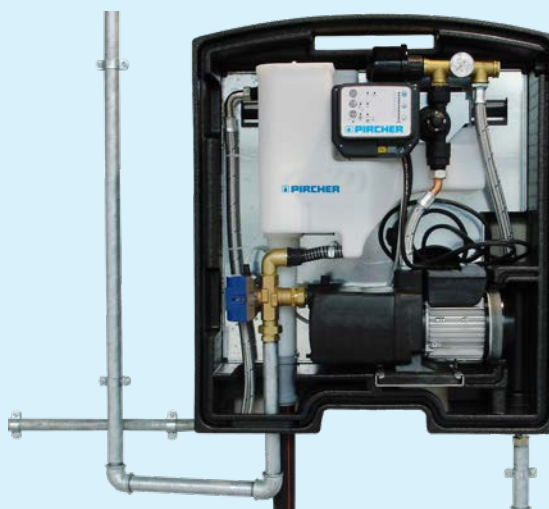
Struttura interna della centralina Pircher "a parete"
